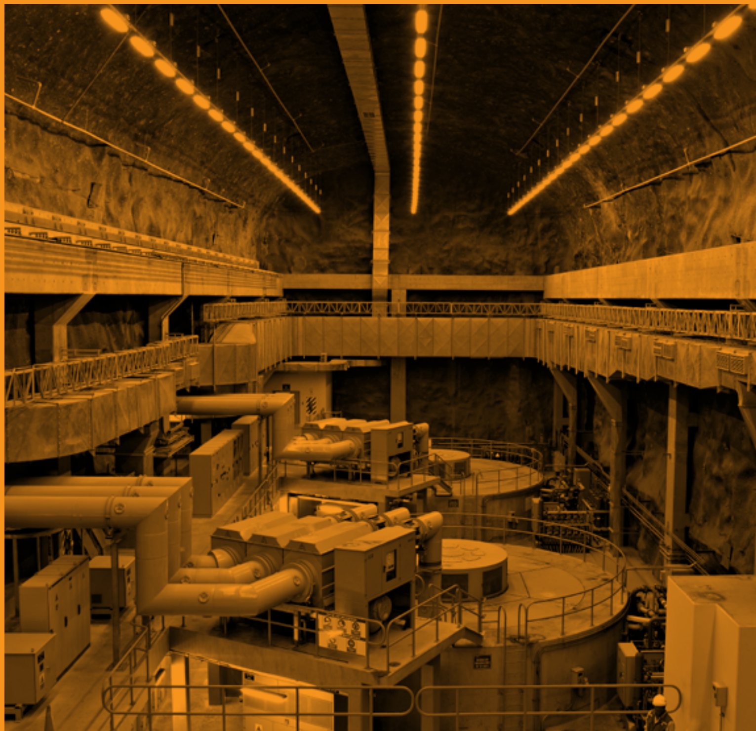
Casa de máquinas, central hidroeléctrica El Platanal, CELEPSA. Cañete, Lima, Perú.
